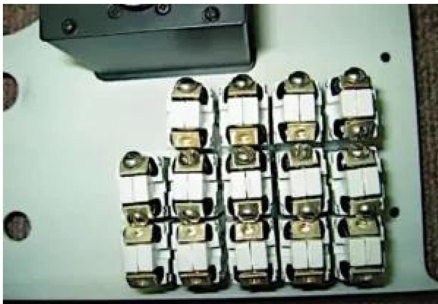
Photo 4... mais face arrière, les breakers sont dangereusement proches les uns des autres.
